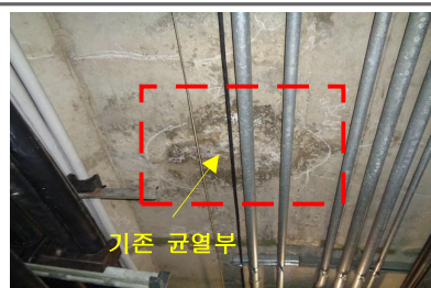
0K468 상부슬래브 균열부누수(b)(0.25m×0.4m)
